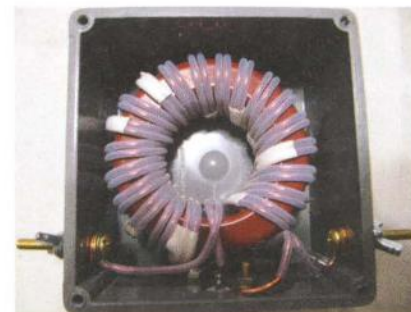
Obr. 6. Umístění oddělovacího transformátoru ve vodotěsné skřínce
